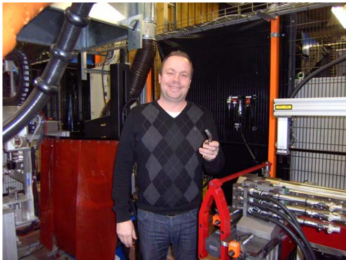
Larsa Bertilsson, inköpschef på Autotube AB i Varberg visar stolt upp den nya helautomatiska cellen där en Herber 150S är installerad.
